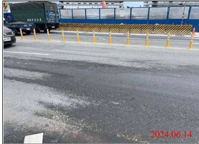
巡查日期地點：1137.06.14/ Y22車站 照片說明：道路路面龜裂情況
