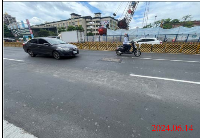
巡查日期地點：113.06.14/ Y23車站 照片說明：道路路面龜裂情況
