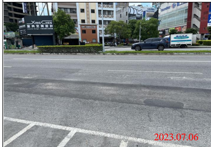
巡查日期地點：112.07.06/ Y2車站 照片說明：路面龜裂狀況
