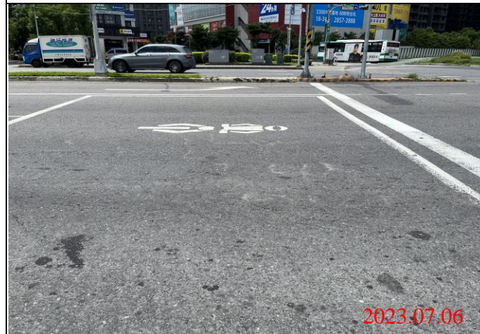
巡查日期地點：112.07.06/ Y22車站 照片說明：路面龜裂狀況
