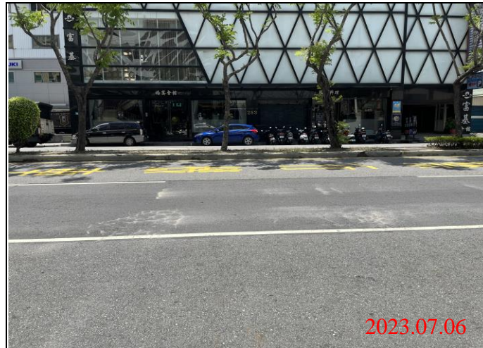
巡查日期地點：112.07.06/ Y21車站 照片說明：路面龜裂狀況
