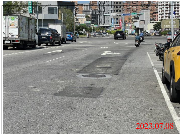
巡查日期地點：112.07.08/ Y22車站 照片說明：路面龜裂狀況
