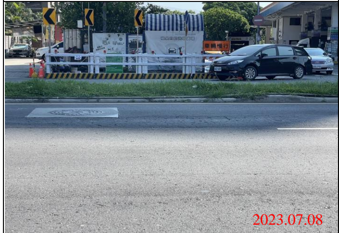
巡查日期地點：112.07.08/ Y23車站 照片說明：路面龜裂狀況
