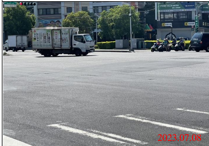
巡查日期地點：112.07.08/ Y22車站 照片說明：路面龜裂狀況
