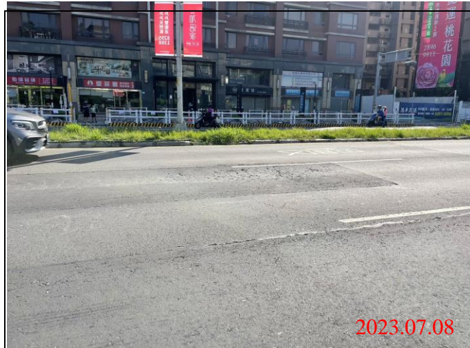
巡查日期地點：112.07.08/ Y23車站 照片說明：路面龜裂狀況
