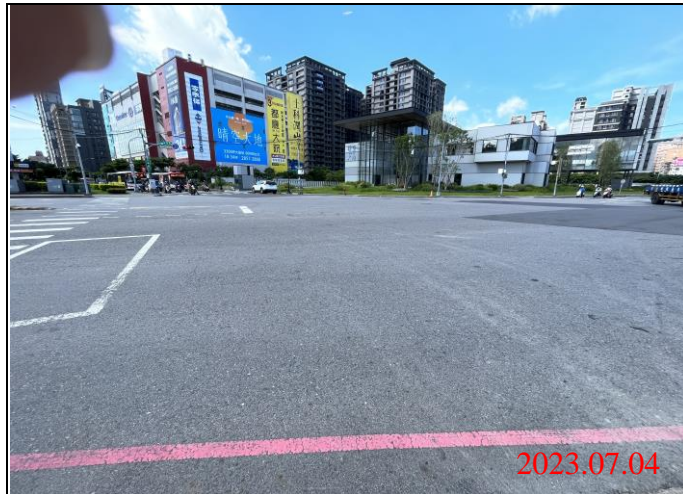
巡查日期地點：112.07.04/ Y22車站 照片說明：路面狀況
