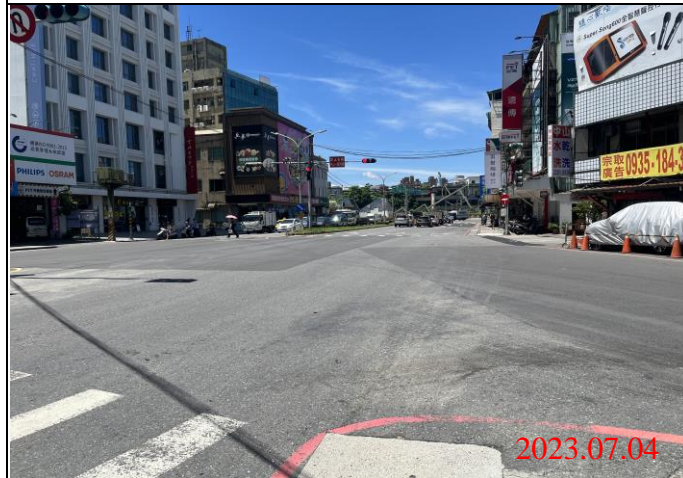
巡查日期地點：112.07.04/ Y21車站 照片說明：路面狀況
