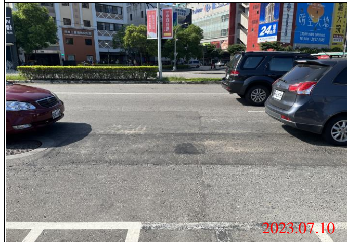
巡查日期地點：112.07.10/ Y22車站 照片說明：路面龜裂狀況
