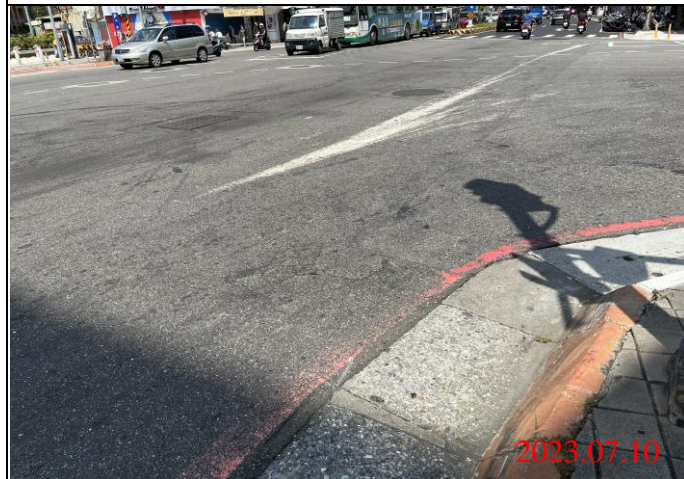
巡查日期地點：112.07.10/ Y21車站 照片說明：路面龜裂狀況
