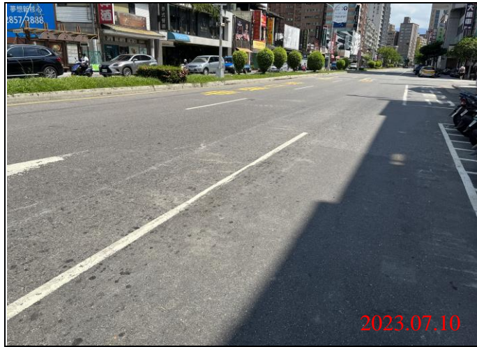
巡查日期地點：112.07.10/ Y21車站 照片說明：路面龜裂狀況
