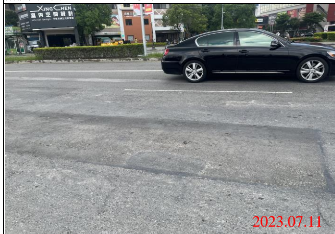
巡查日期地點：112.07.11/ Y22車站 照片說明：路面龜裂狀況
