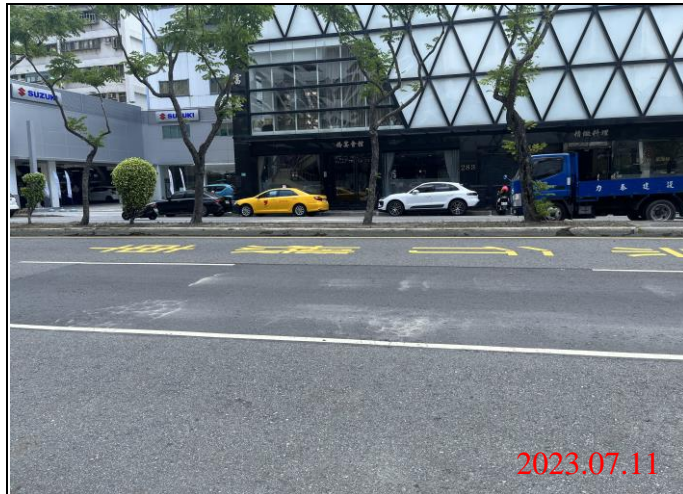
巡查日期地點：112.07.11/ Y21車站 照片說明：路面龜裂狀況
