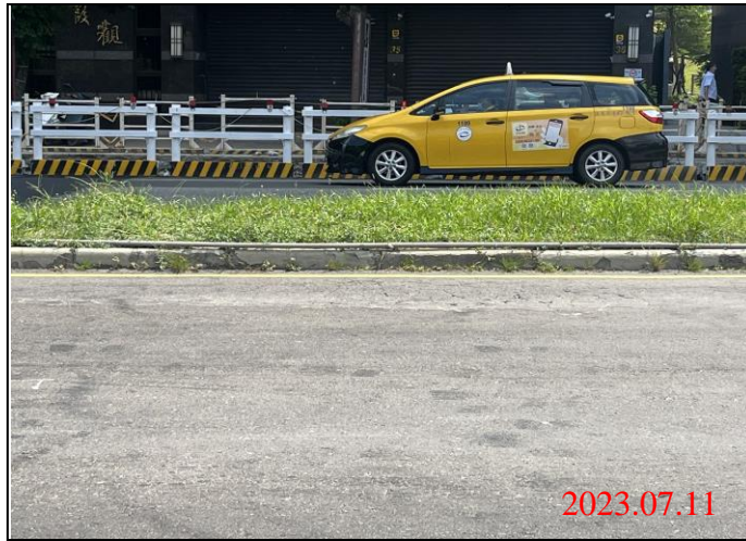
巡查日期地點：112.07.11/ Y23車站 照片說明：路面龜裂狀況
