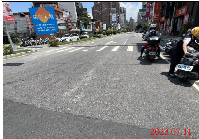
巡查日期地點：112.07.11/ Y21車站 照片說明：路面龜裂狀況
