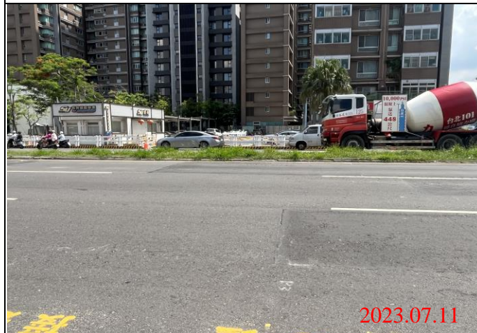
巡查日期地點：112.07.11/ Y23車站 照片說明：路面龜裂狀況
