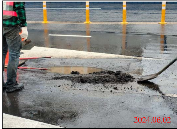
巡查日期地點：113.06.02/ Y22車站 照片說明：道路坑洞
