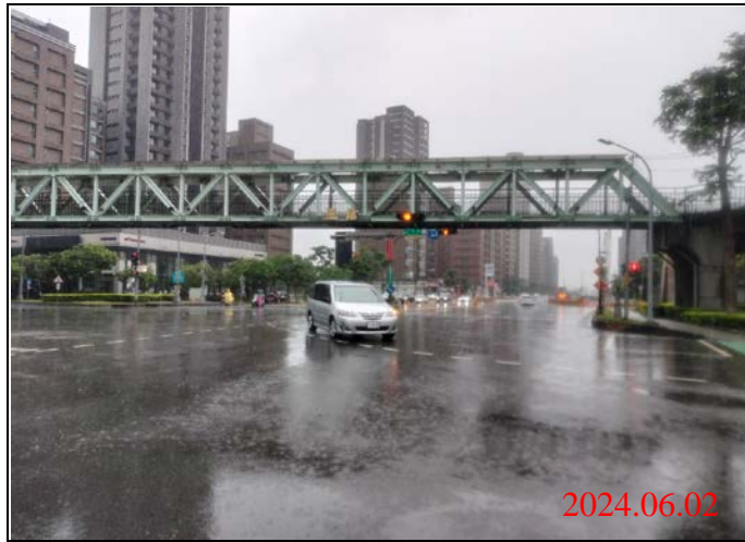
巡查日期地點：113.06.02/-23車站 照片說明：路面狀況
