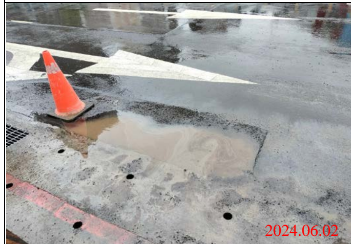
巡查日期地點：113.06.02/ Y22車站 照片說明：道路坑洞
