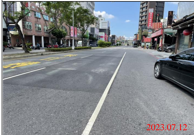
巡查日期地點：112.07.12/ Y21車站 照片說明：路面龜裂狀況
