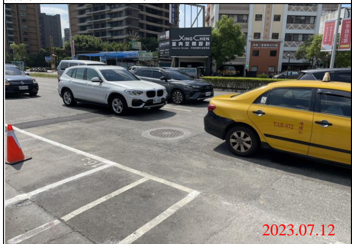
巡查日期地點：112.07.12/ Y22車站 照片說明：路面龜裂狀況
