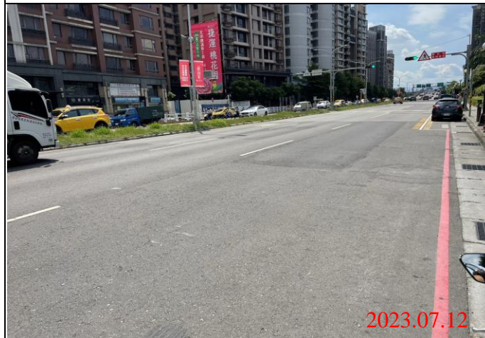
巡查日期地點：112.07.12/ Y23車站 照片說明：路面龜裂狀況
