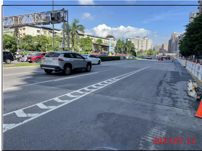
巡查日期地點：112.07.12/ Y23車站 照片說明：路面龜裂狀況
