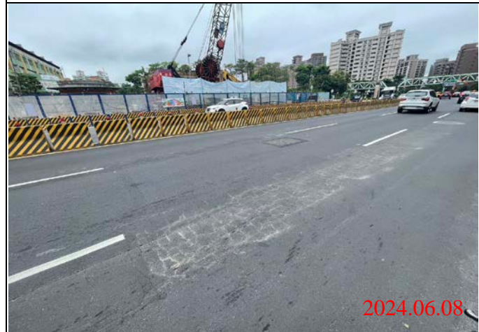
巡查日期地點：113.06.08/ Y23車站 照片說明：路面龜裂狀況
