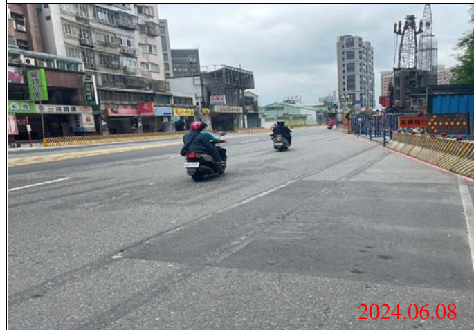
巡查日期地點：113.06.08/ Y22車站 照片說明：路面龜裂狀況
