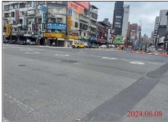
巡查日期地點：113.06.08/ Y21車站 照片說明：路面龜裂狀況
