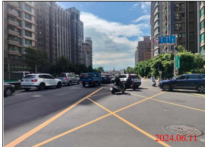
巡查日期地點：113.06.11/-23車站 照片說明：路面狀況
