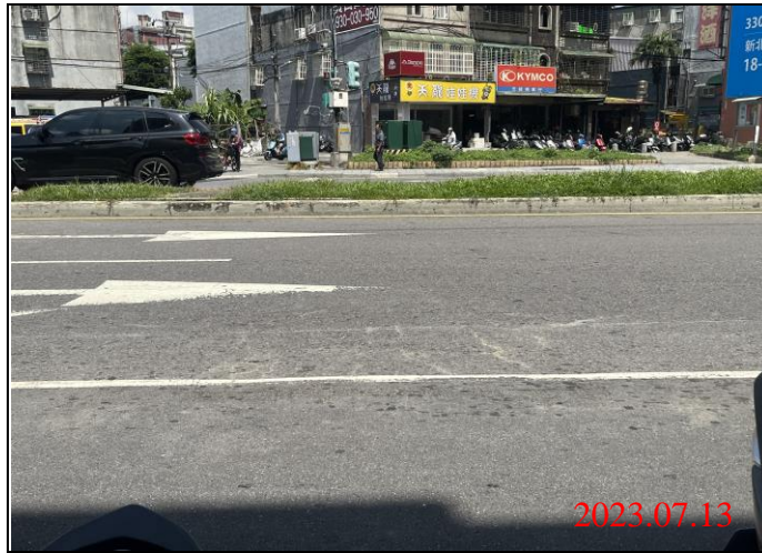
巡查日期地點：112.07.13/ Y21車站 照片說明：路面龜裂狀況
