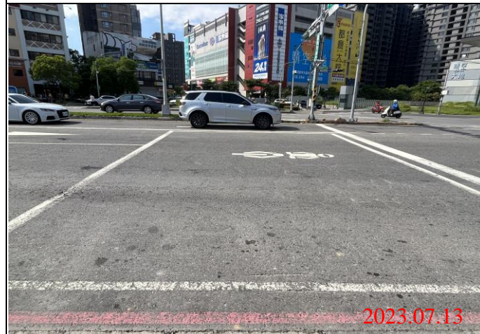
巡查日期地點：112.07.13/ Y22車站 照片說明：路面龜裂狀況
