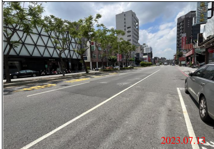
巡查日期地點：112.07.13/ Y21車站 照片說明：路面龜裂狀況
