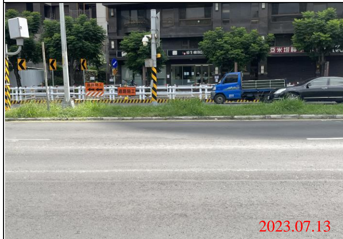
巡查日期地點：112.07.13/ Y23車站 照片說明：路面龜裂狀況
