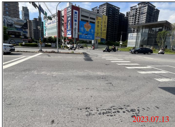
巡查日期地點：112.07.13/ Y22車站 照片說明：路面龜裂狀況
