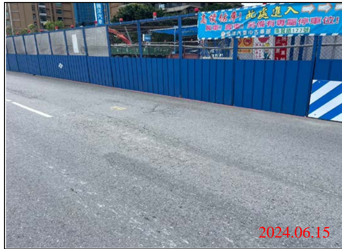
巡查日期地點：1137.06.15/ Y22車站 照片說明：道路路面龜裂情況
