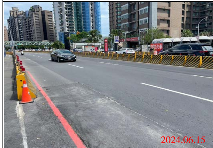
巡查日期地點：113.06.15/ Y23車站 照片說明：道路路面龜裂情況
