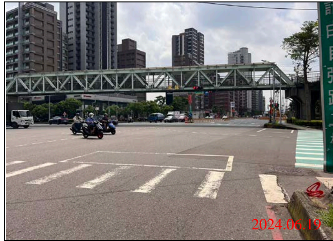
巡查日期地點：113.06.19/-23車站 照片說明：路面狀況
