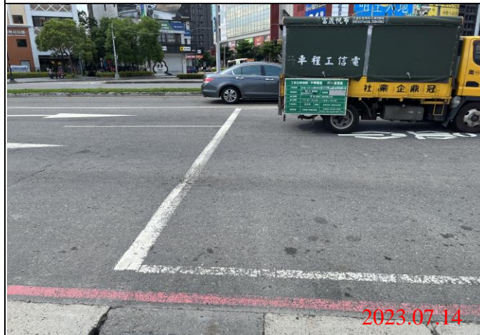
巡查日期地點：112.07.14/ Y22車站 照片說明：路面龜裂狀況
