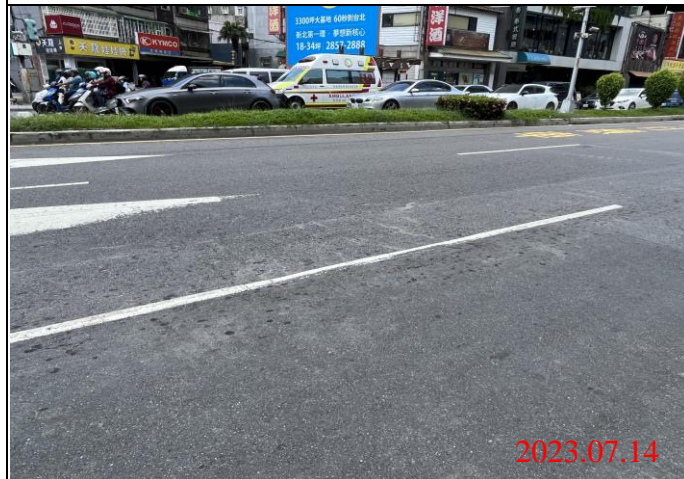
巡查日期地點：112.07.14/ Y21車站 照片說明：路面龜裂狀況
