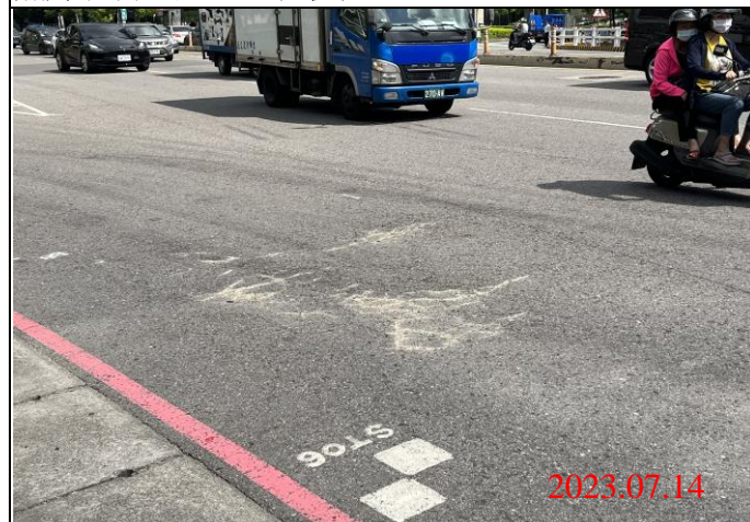
巡查日期地點：112.07.14/ Y23車站 照片說明：路面龜裂狀況
