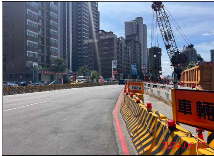
巡查日期地點：113.06.22/23車站 照片說明：路面狀況
