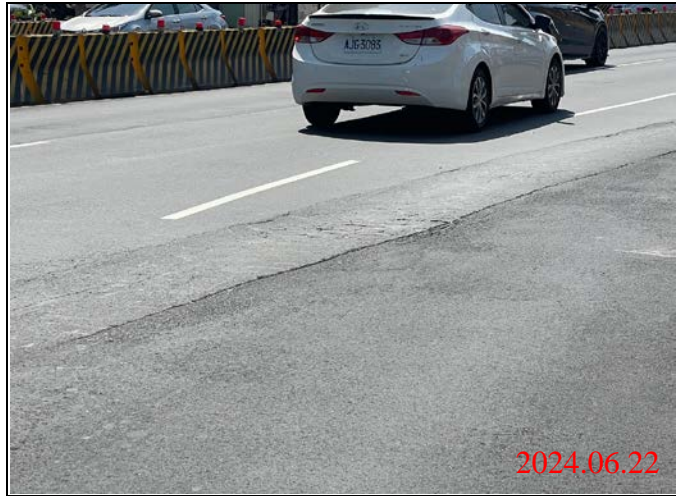
巡查日期地點：113.06.22/ Y23車站 照片說明：路面龜裂
