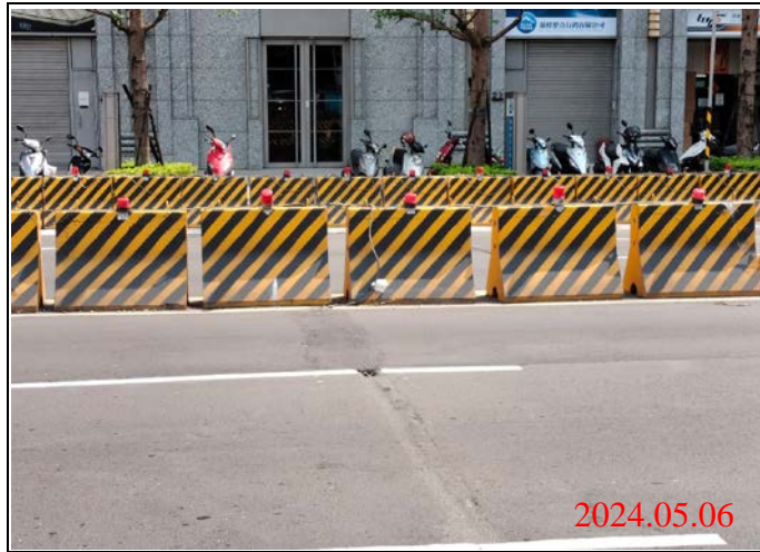
巡查日期地點：113.05.06/ Y21車站 照片說明：道路龜裂
