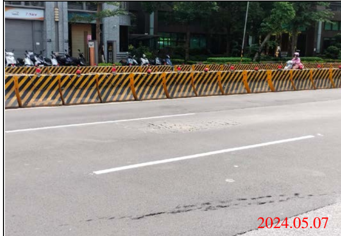
巡查日期地點：113.05.07/ Y23車站 照片說明：道路坑洞
