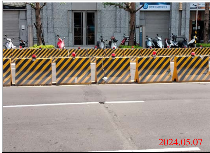
巡查日期地點：113.05.07/ Y23車站 照片說明：道路龜裂
