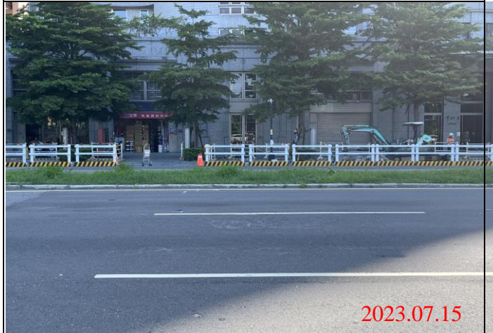
巡查日期地點：112.07.15/ Y23車站 照片說明：路面龜裂狀況
