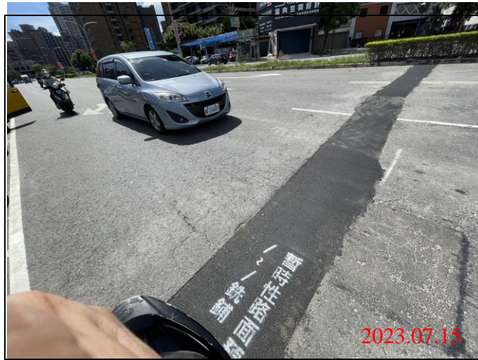
巡查日期地點：112.07.15/ Y22車站 照片說明：路面龜裂狀況
