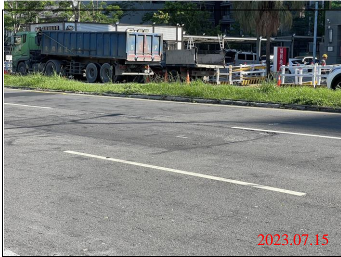
巡查日期地點：112.07.15/ Y23車站 照片說明：路面龜裂狀況
