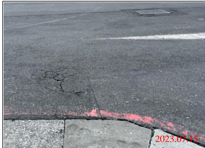
巡查日期地點：112.07.15/ Y21車站 照片說明：路面龜裂狀況
