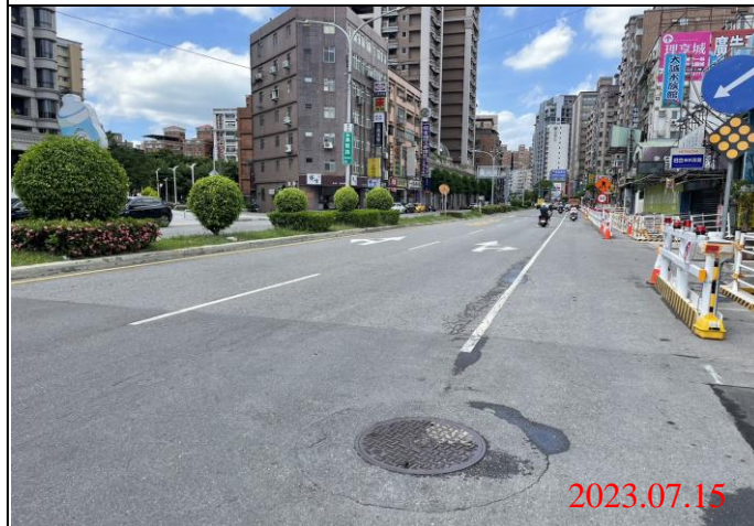
巡查日期地點：112.07.15/ Y22車站 照片說明：路面龜裂狀況
