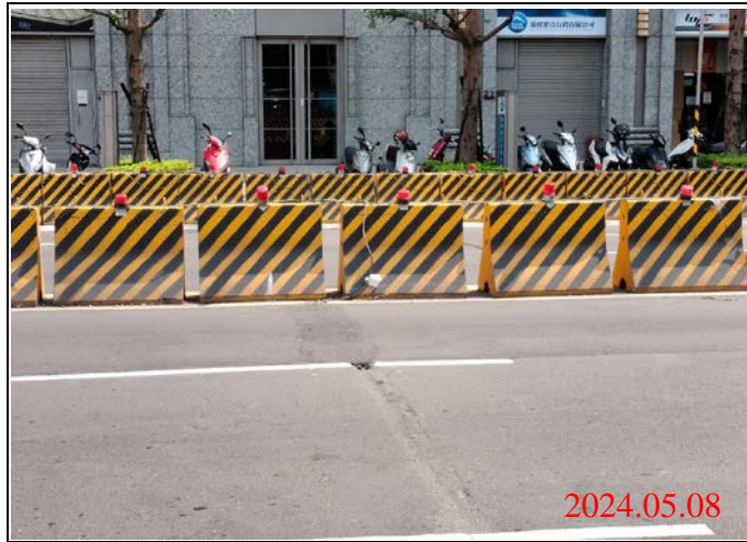
巡查日期地點：113.05.08/ Y23車站 照片說明：道路龜裂
