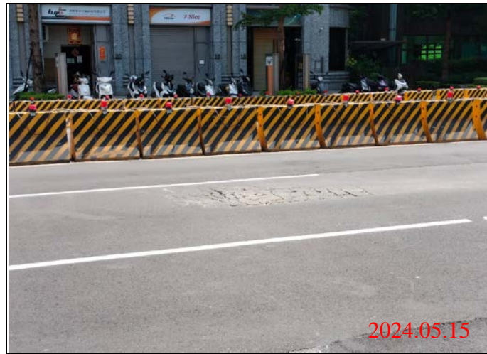
巡查日期地點：113.05.15/ Y23車站 照片說明：南側道路龜裂
