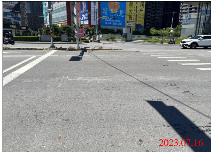
巡查日期地點：112.07.16/ Y22車站 照片說明：路面龜裂狀況
