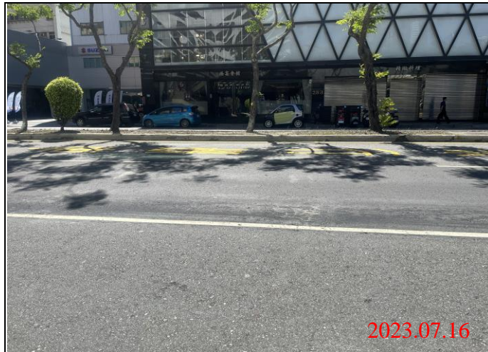
巡查日期地點：112.07.16/ Y21車站 照片說明：路面龜裂狀況
