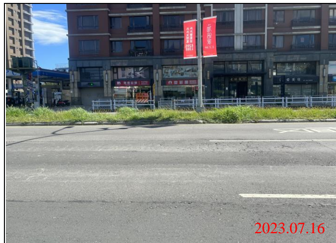
巡查日期地點：112.07.16/ Y23車站 照片說明：路面龜裂狀況
