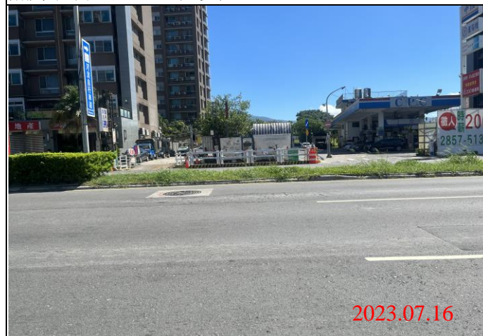
巡查日期地點：112.07.16/ Y23車站 照片說明：路面龜裂狀況
