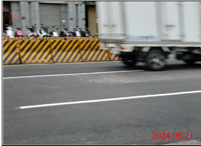
巡查日期地點：113.05.21/ Y23車站 照片說明：南側道路龜裂
