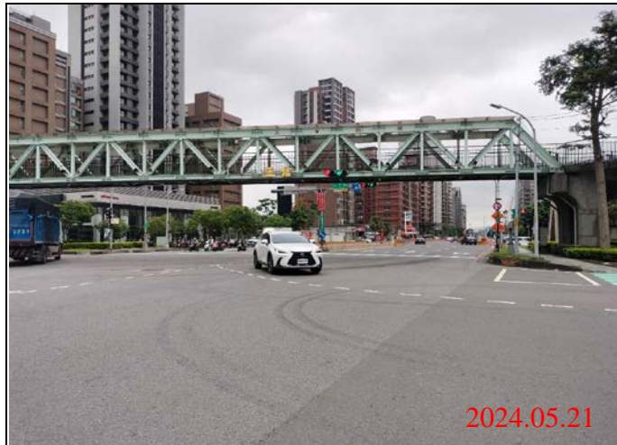
巡查日期地點：113.05.21/-23車站 照片說明：路面狀況
