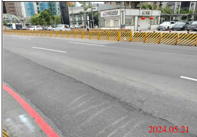
巡查日期地點：113.05.21/ Y23車站 照片說明：南側道路龜裂
