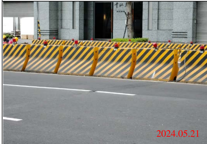
巡查日期地點：113.05.21/ Y23車站 照片說明：南側道路坑洞
