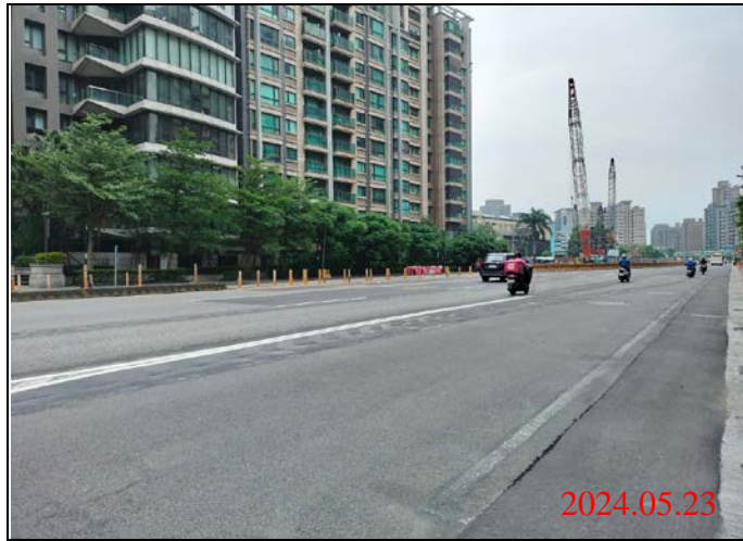
巡查日期地點：113.05.23/-23車站 照片說明：路面狀況
