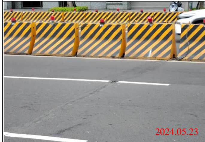
巡查日期地點：113.05.23/ Y23車站 照片說明：南側道路坑洞
