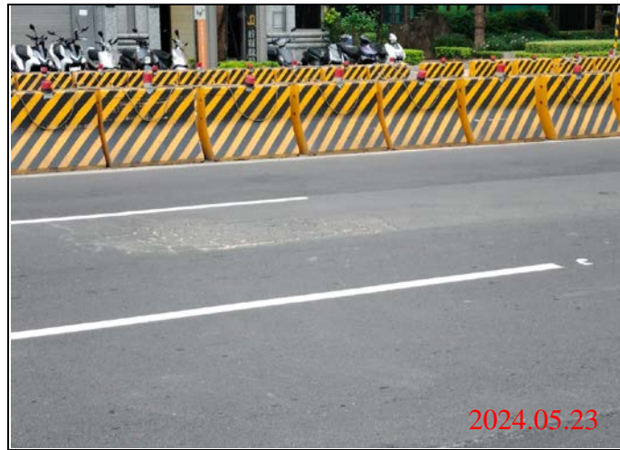
巡查日期地點：113.05.23/ Y23車站 照片說明：南側道路龜裂
