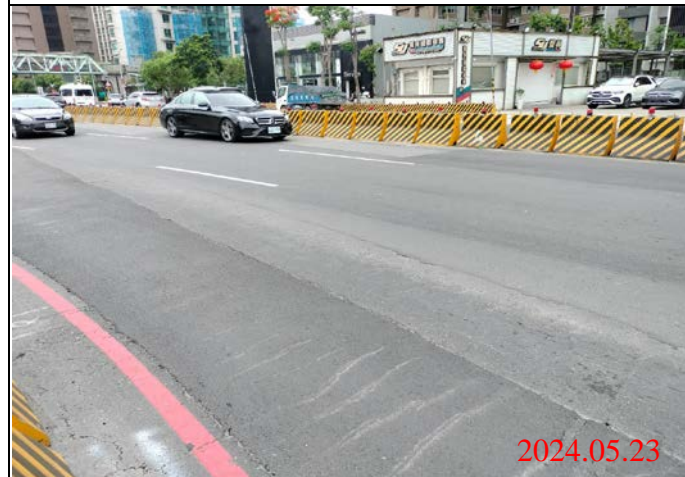
巡查日期地點：113.05.23/ Y23車站 照片說明：南側道路龜裂
