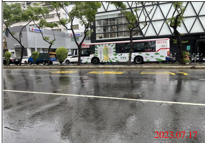
巡查日期地點：112.07.17/ Y21車站 照片說明：路面龜裂狀況
