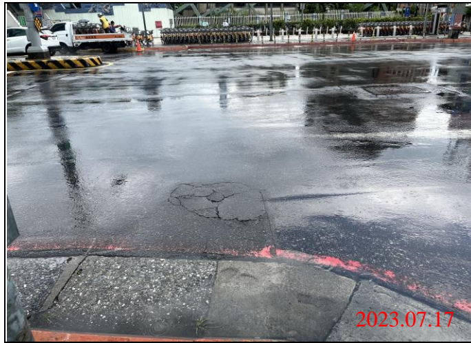
巡查日期地點：112.07.17/ Y21車站 照片說明：路面龜裂狀況
