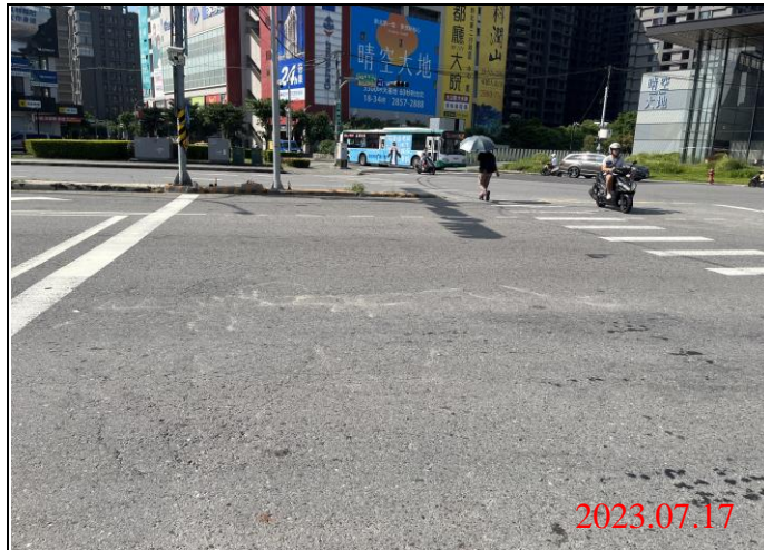
巡查日期地點：112.07.17/ Y22車站 照片說明：路面龜裂狀況
