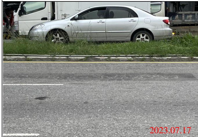
巡查日期地點：112.07.17/ Y23車站 照片說明：路面龜裂狀況
