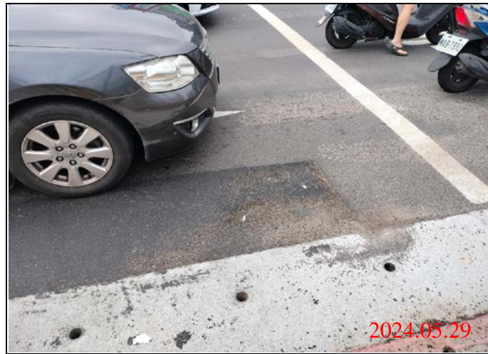
巡查日期地點：113.05.29/ Y22車站 照片說明：道路下陷
