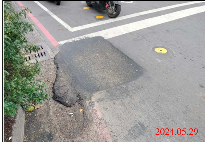
巡查日期地點：113.05.29/ Y22車站 照片說明：道路下陷
