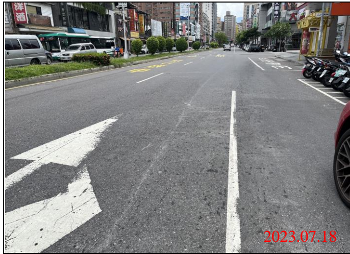
巡查日期地點：112.07.18/ Y21車站 照片說明：路面龜裂狀況
