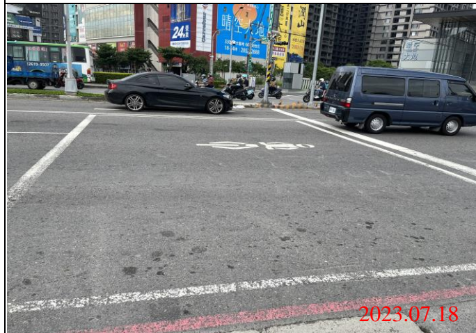
巡查日期地點：112.07.18/ Y22車站 照片說明：路面龜裂狀況
