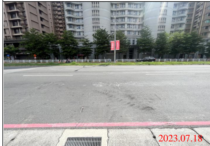
巡查日期地點：112.07.18/ Y23車站 照片說明：路面龜裂狀況
