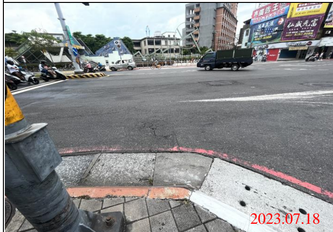
巡查日期地點：112.07.18/ Y21車站 照片說明：路面龜裂狀況
