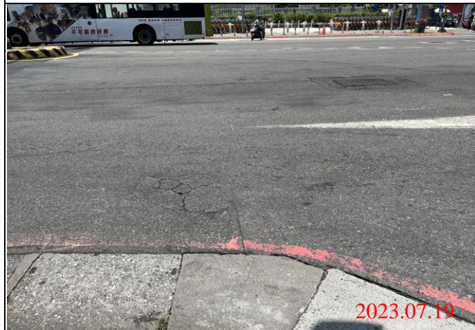
巡查日期地點：112.07.19/ Y21車站 照片說明：路面龜裂狀況
