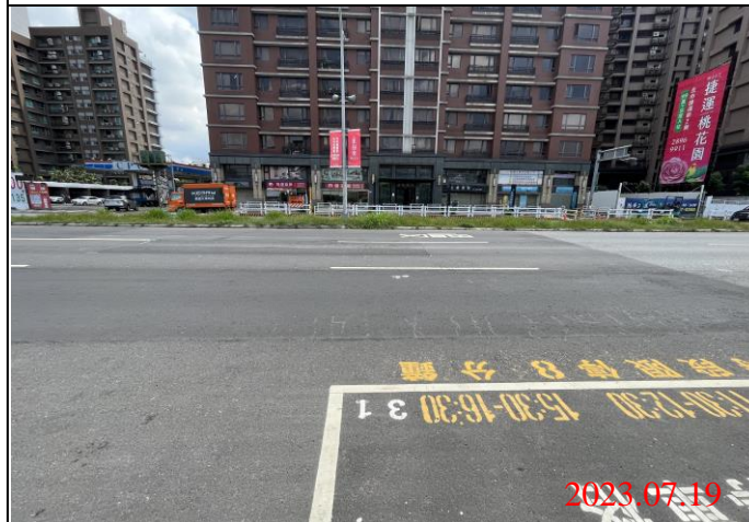
巡查日期地點：112.07.19/ Y23車站 照片說明：路面龜裂狀況
