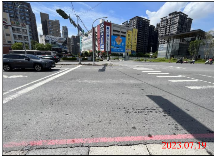
巡查日期地點：112.07.19/ Y22車站 照片說明：路面龜裂狀況
