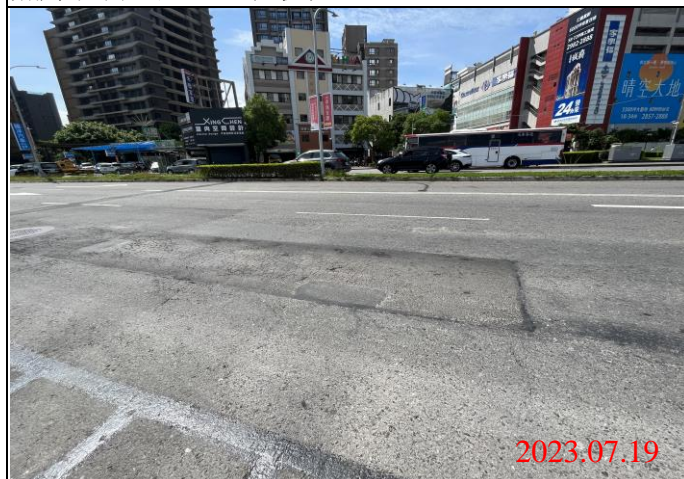
巡查日期地點：112.07.19/ Y22車站 照片說明：路面龜裂狀況
