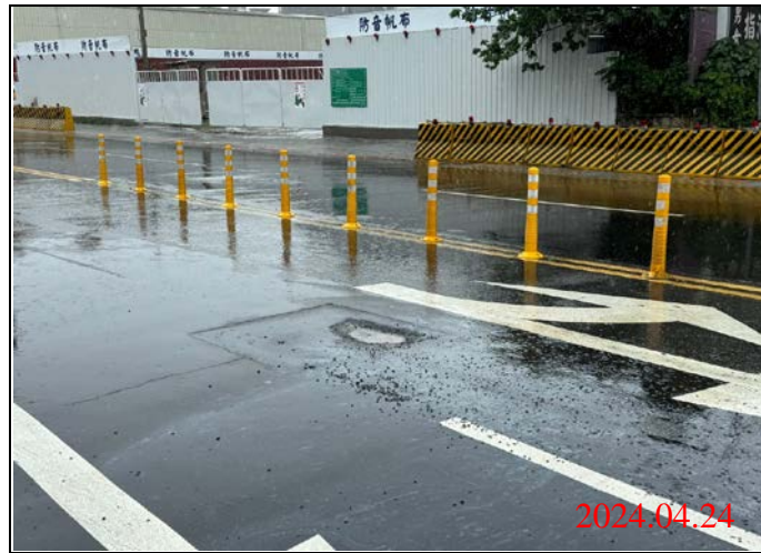
巡查日期地點：113.04.24/ Y22車站 照片說明：道路坑洞-改善前
