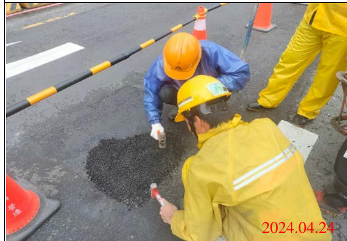
巡查日期地點：113.04.24/ Y22車站 照片說明：道路坑洞-改善中
