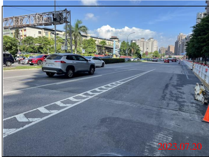
巡查日期地點：112.07.20/ Y23車站 照片說明：路面龜裂狀況
