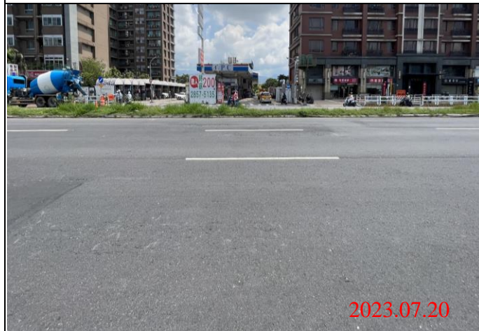
巡查日期地點：112.07.20/ Y23車站 照片說明：路面龜裂狀況
