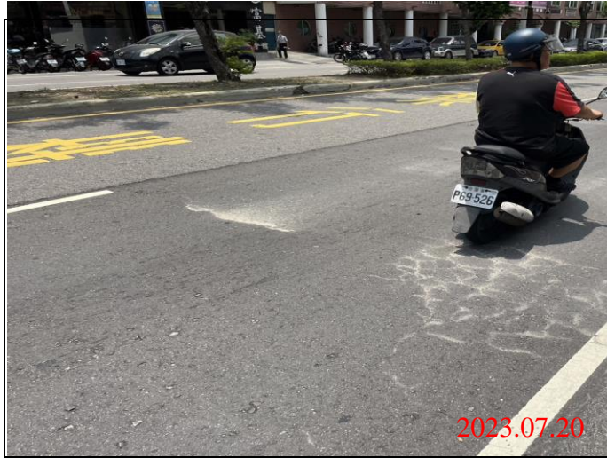
巡查日期地點：112.07.20/ Y21車站 照片說明：路面龜裂狀況
