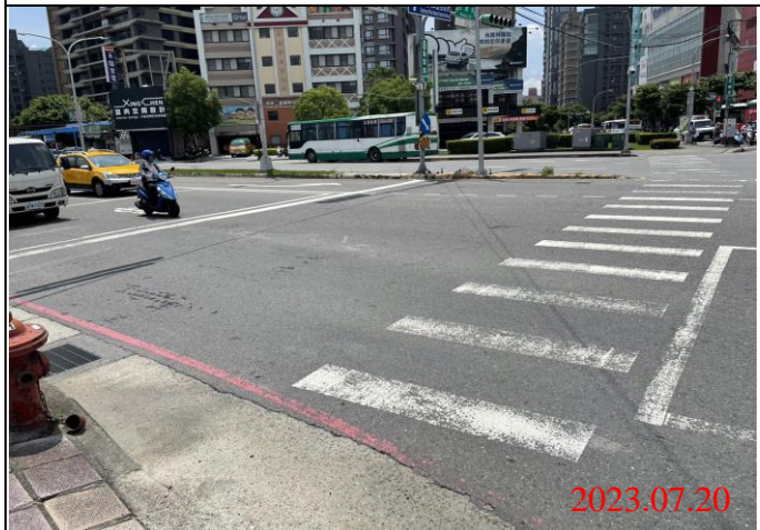
巡查日期地點：112.07.20/ Y22車站 照片說明：路面龜裂狀況
