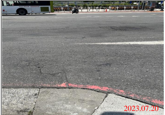
巡查日期地點：112.07.20/ Y21車站 照片說明：路面龜裂狀況
