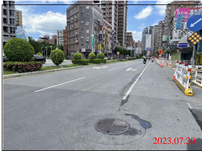
巡查日期地點：112.07.20/ Y22車站 照片說明：路面龜裂狀況
