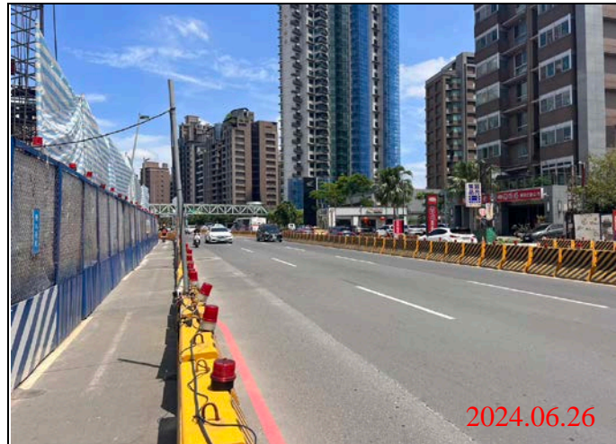
巡查日期地點：113.06.26/-23車站 照片說明：路面狀況
