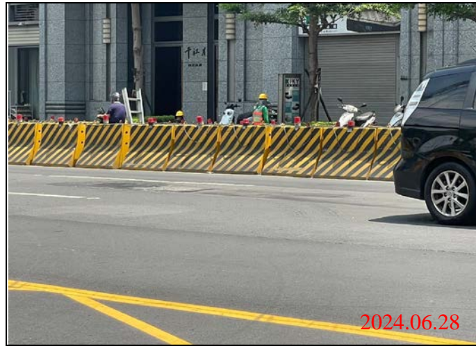
巡查日期地點：113.06.28/ Y23車站 照片說明：路面龜裂狀況
