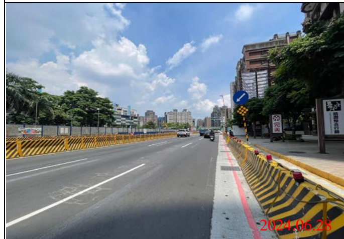
巡查日期地點：113.06.28/ Y23車站 照片說明：路面龜裂狀況
