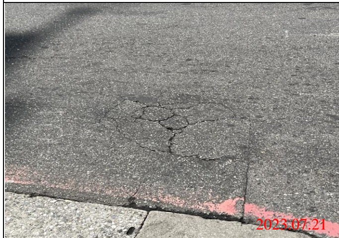
巡查日期地點：112.07.21/ Y21車站 照片說明：路面龜裂狀況
