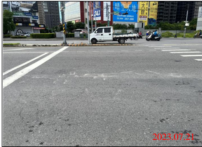
巡查日期地點：112.07.21/ Y22車站 照片說明：路面龜裂狀況
