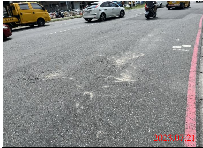
巡查日期地點：112.07.21/ Y23車站 照片說明：路面龜裂狀況
