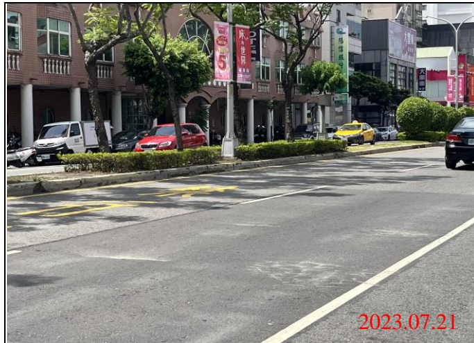
巡查日期地點：112.07.21/ Y21車站 照片說明：路面龜裂狀況
