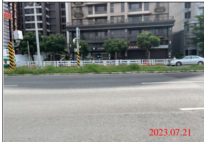
巡查日期地點：112.07.21/ Y23車站 照片說明：路面龜裂狀況
