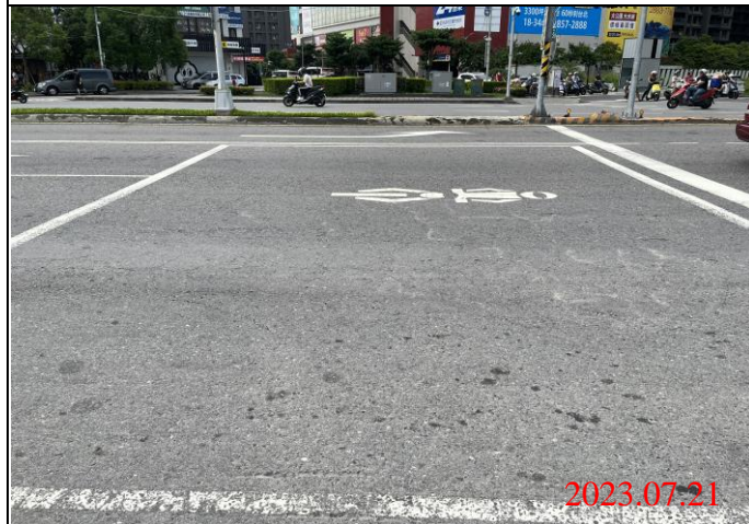
巡查日期地點：112.07.21/ Y22車站 照片說明：路面龜裂狀況
