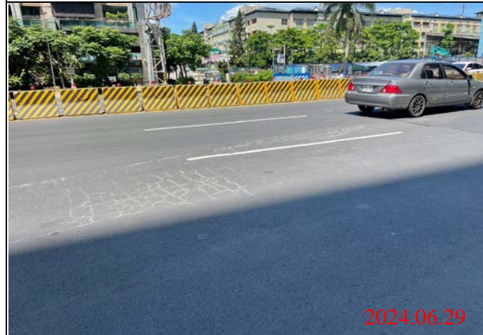
巡查日期地點：113.06.29/ Y23車站 照片說明：路面龜裂狀況
