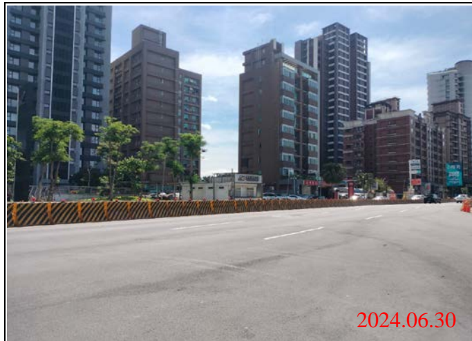
巡查日期地點：113.06.30/-23車站 照片說明：路面狀況
