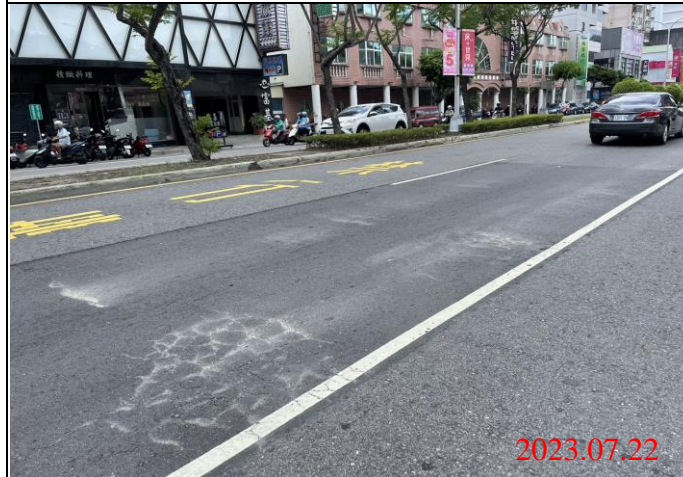
巡查日期地點：112.07.22/ Y21車站 照片說明：路面龜裂狀況
