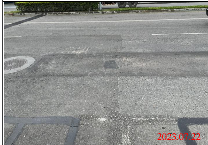
巡查日期地點：112.07.22/ Y22車站 照片說明：路面龜裂狀況
