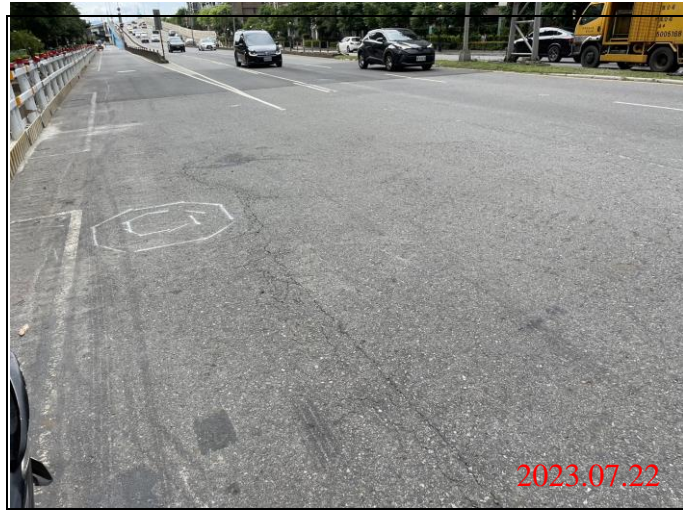
巡查日期地點：112.07.22/ Y21車站 照片說明：路面龜裂狀況
