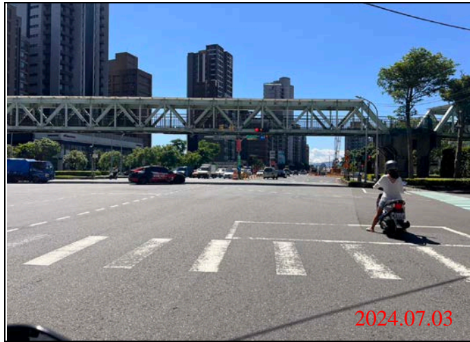
巡查日期地點：113.07.03/-23車站 照片說明：路面狀況
