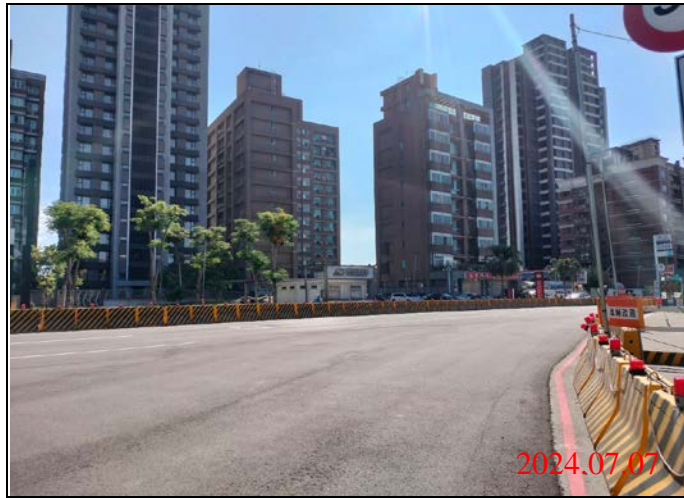
巡查日期地點：113.07.07/-23車站 照片說明：路面狀況
