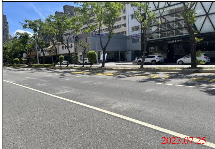
巡查日期地點：112.07.25/ Y21車站 照片說明：路面龜裂狀況
