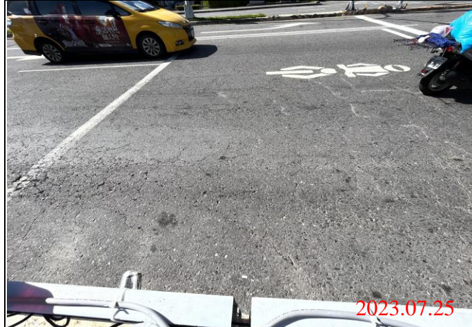
巡查日期地點：112.07.25/ Y22車站 照片說明：路面龜裂狀況
