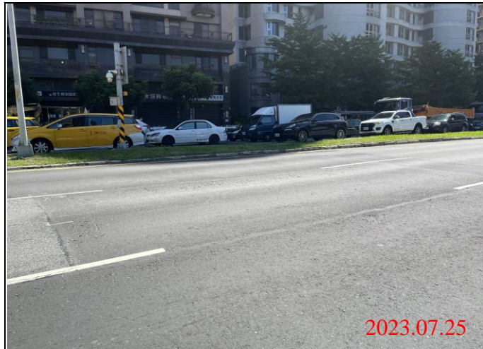
巡查日期地點：112.07.25/ Y23車站 照片說明：路面龜裂狀況
