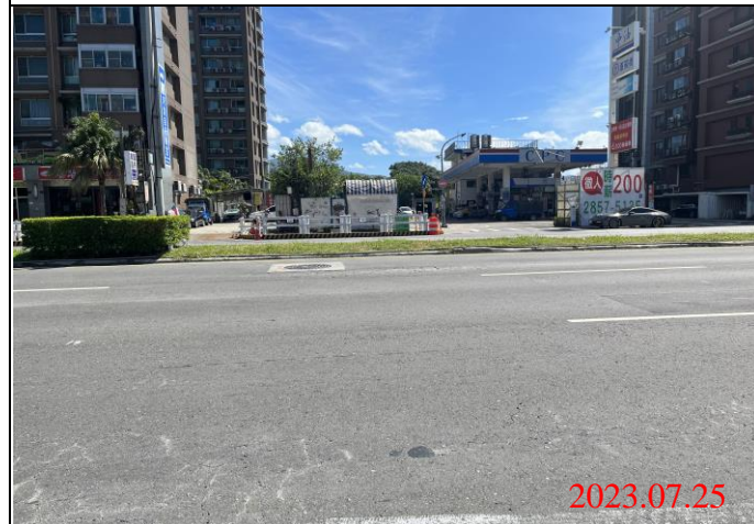
巡查日期地點：112.07.25/ Y23車站 照片說明：路面龜裂狀況
