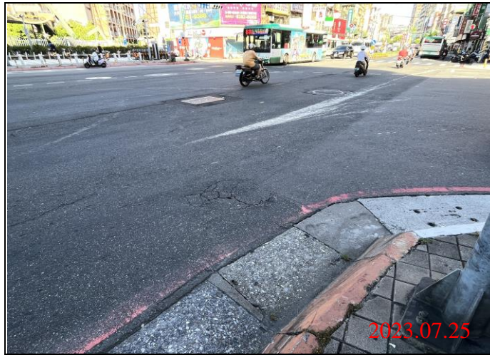
巡查日期地點：112.07.25/ Y21車站 照片說明：路面龜裂狀況
