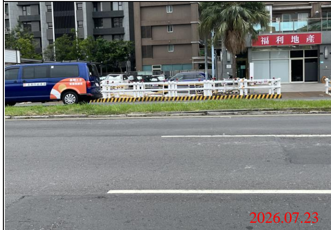
巡查日期地點：112.07.26/ Y233車站 照片說明：路面龜裂狀況
