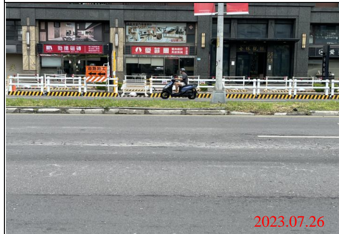
巡查日期地點：112.07.26/ Y23車站 照片說明：路面龜裂狀況
