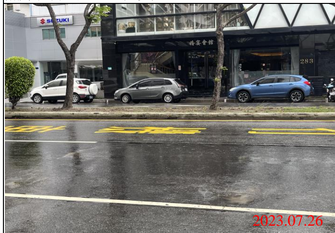
巡查日期地點：112.07.26/ Y21車站 照片說明：路面龜裂狀況
