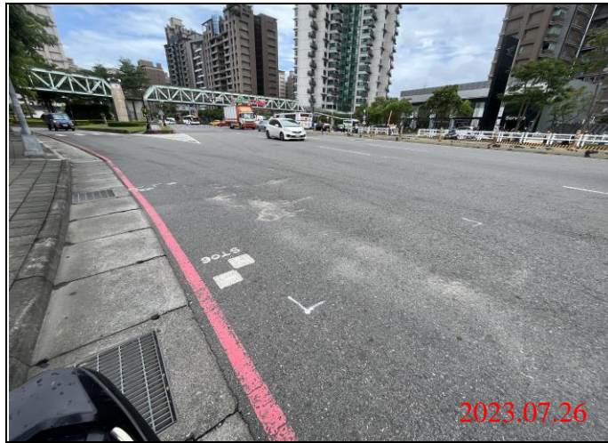
巡查日期地點：112.07.26/ Y23車站 照片說明：路面龜裂狀況
