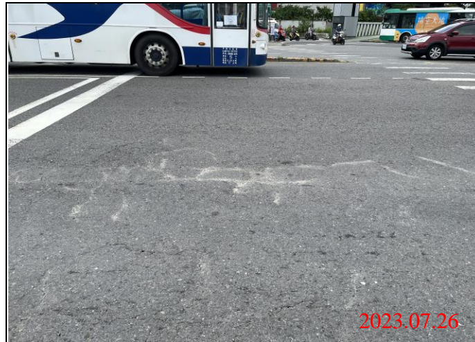
巡查日期地點：112.07.26/ Y22車站 照片說明：路面龜裂狀況
