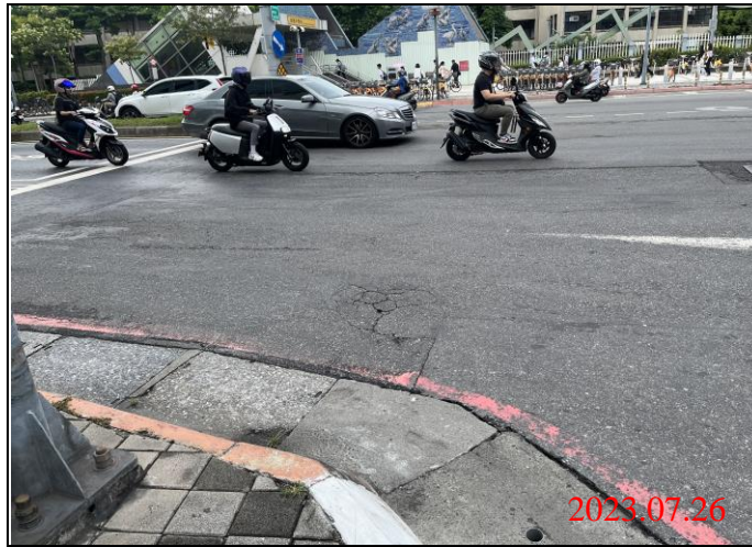
巡查日期地點：112.07.26/ Y21車站 照片說明：路面龜裂狀況
