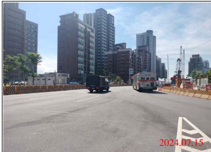
巡查日期地點：113.07.15/-23車站 照片說明：路面狀況
