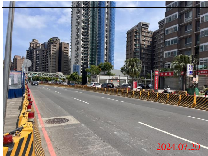
巡查日期地點：113.07.20/-23車站 照片說明：路面狀況
