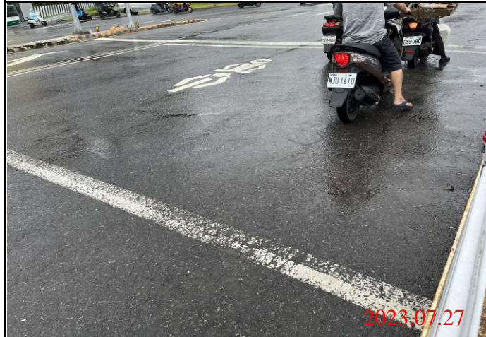
巡查日期地點：112.07.27/ Y22車站 照片說明：路面龜裂狀況
