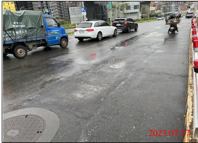
巡查日期地點：112.07.27/ Y22車站 照片說明：路面龜裂狀況
