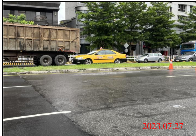
巡查日期地點：112.07.27/ Y23車站 照片說明：路面龜裂狀況
