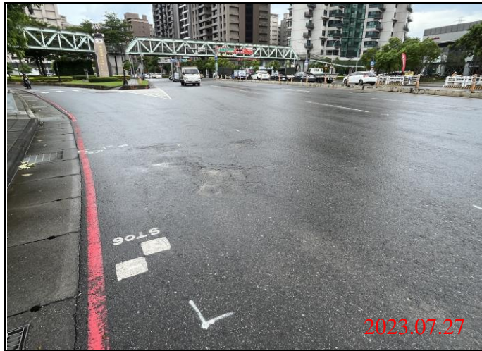
巡查日期地點：112.07.27/ Y23車站 照片說明：路面龜裂狀況
