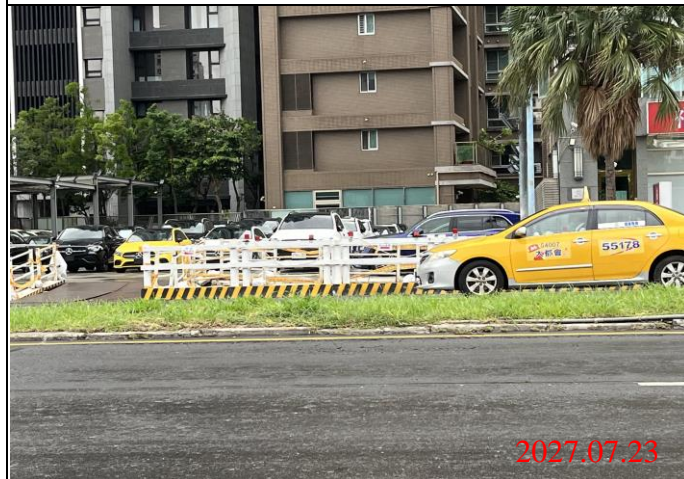
巡查日期地點：112.07.27/ Y233車站 照片說明：路面龜裂狀況
