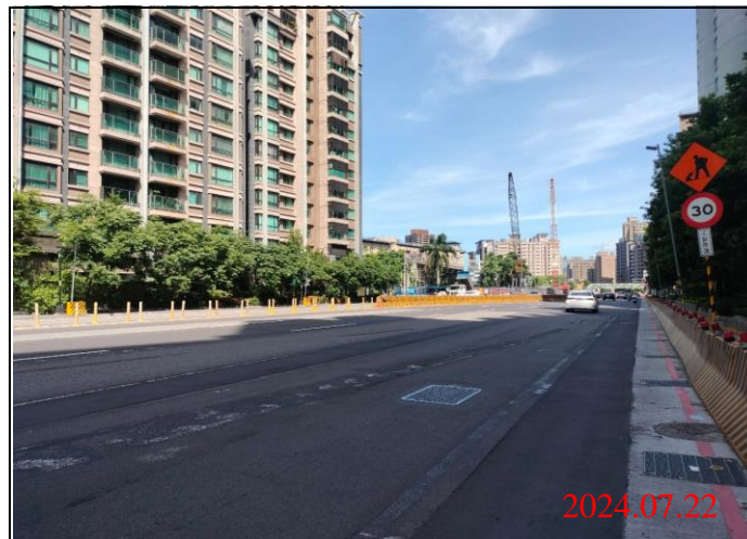
巡查日期地點：113.07.22/-23車站 照片說明：路面狀況
