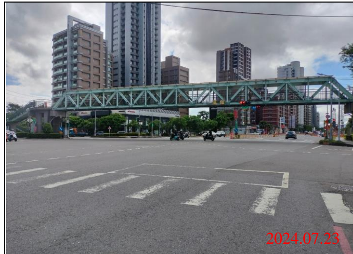
巡查日期地點：113.07.23/-23車站 照片說明：路面狀況
