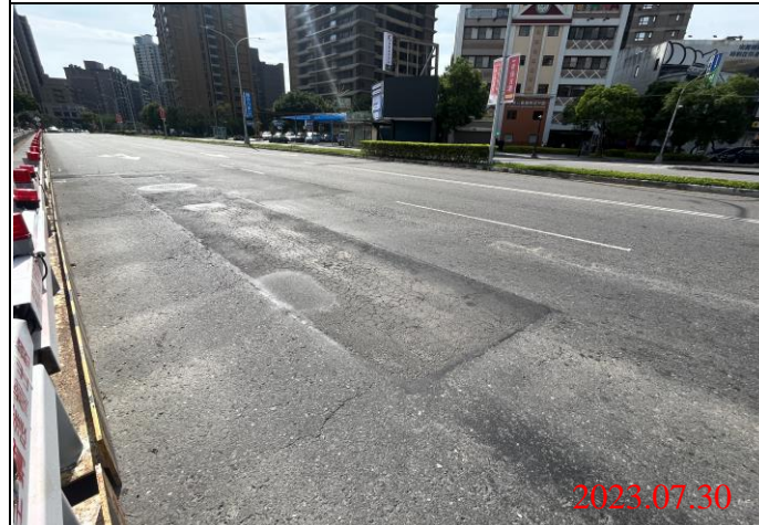
巡查日期地點：112.07.30/ Y22車站 照片說明：路面龜裂狀況
