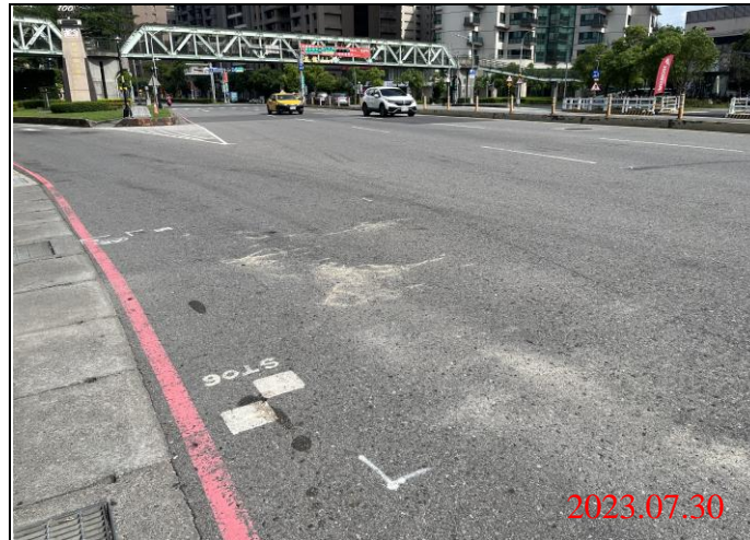
巡查日期地點：112.07.30/ Y23車站 照片說明：路面龜裂狀況
