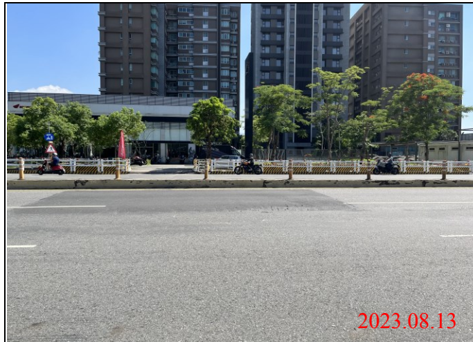
巡查日期地點：112.08.13/ Y23車站 照片說明：路面龜裂狀況
