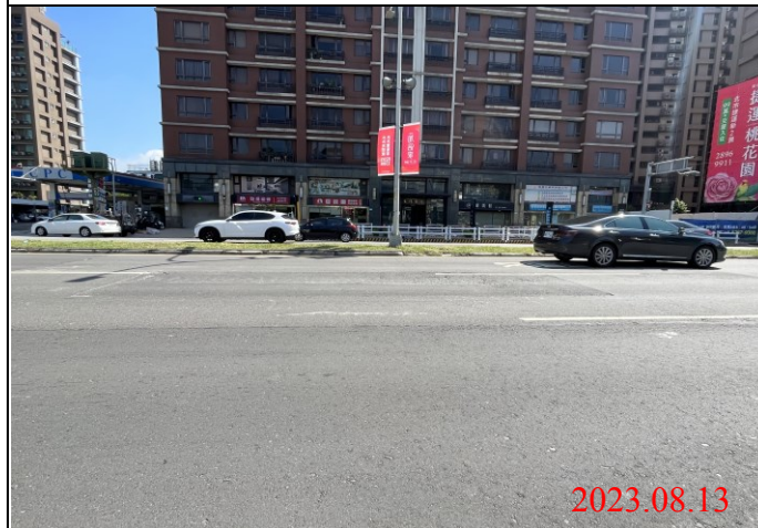
巡查日期地點：112.08.13/ Y23車站 照片說明：路面龜裂狀況
