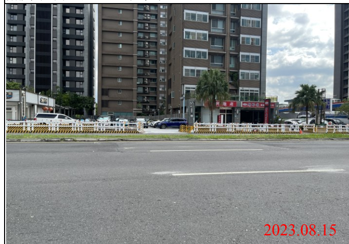
巡查日期地點：112.08.15/ Y23車站 照片說明：路面龜裂狀況
