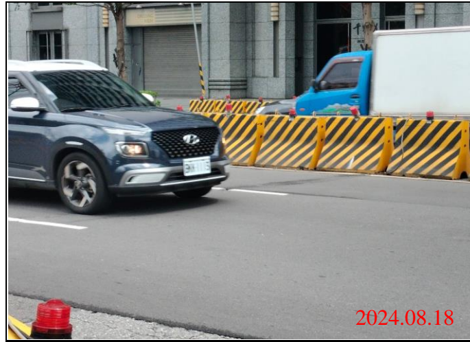
巡查日期地點：113.08.18/ Y23車站 照片說明：道路龜裂
