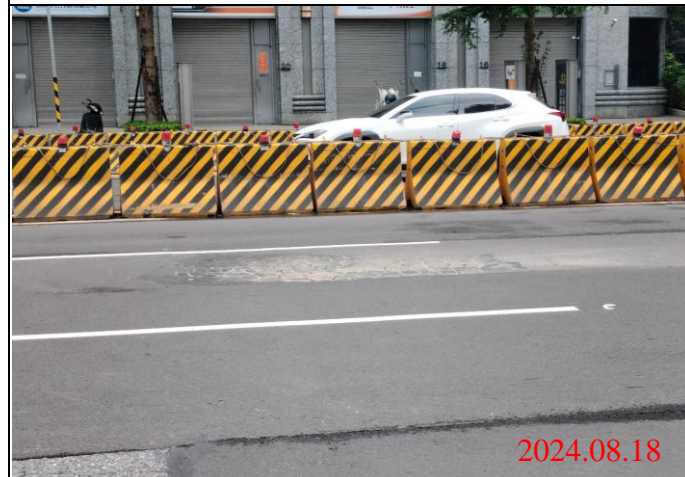
巡查日期地點：113.08.18/ Y23車站 照片說明：道路龜裂
