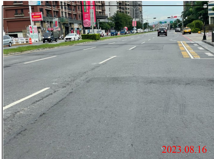
巡查日期地點：112.08.16/ Y23車站 照片說明：路面龜裂狀況
