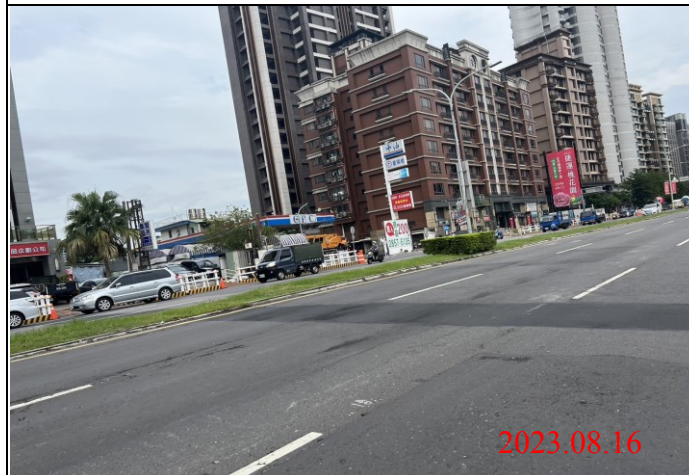
巡查日期地點：112.08.16/ Y23車站 照片說明：路面龜裂狀況
