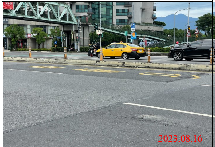
巡查日期地點：112.08.16/ Y23車站 照片說明：路面龜裂狀況
