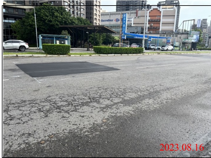
巡查日期地點：112.08.16/ Y22車站 照片說明：路面龜裂狀況
